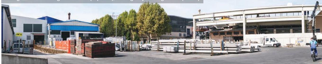
Levo: gradbena dela za regalno skladišče (Impol LLT), desno: gradnja žarilnega centra (Rondal)
